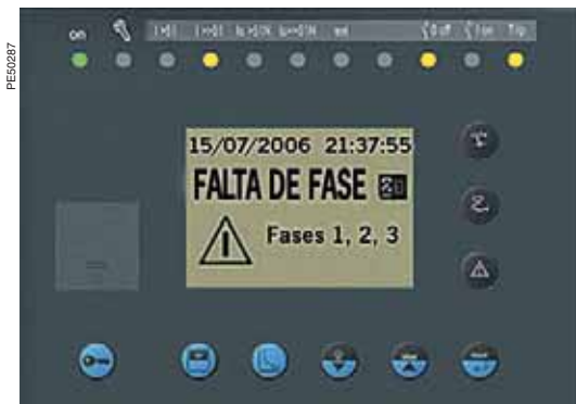
Sinalização local no painel frontal do Sepam.
